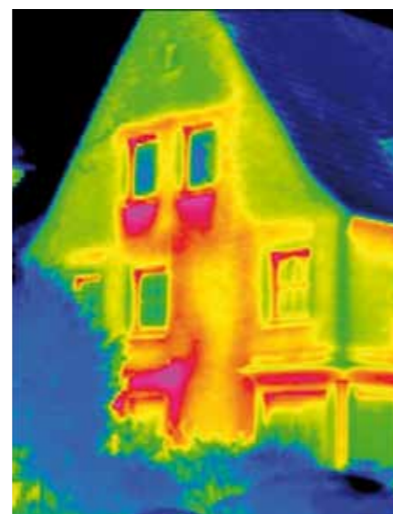
Termografski posnetek prikazuje toplotne izgube skozi fasado.
